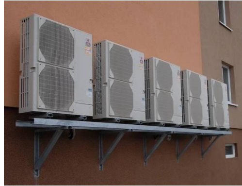
př. TČ (venkovní jednotka) na fasádě
